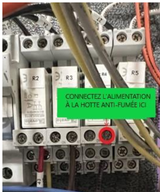
Câblage de la hotte de fumée
