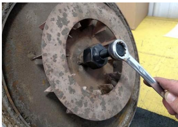
L'outil d'extraction du ventilateur AHS est prêt à l'emploi
